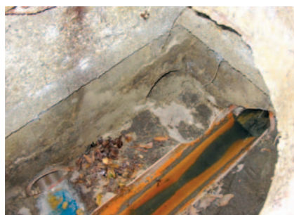
Canale di scolo e banchina difettosi
