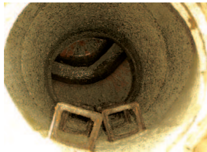
Corrosione sul clinker e fughe anermetiche
