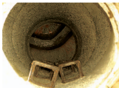
Corrosione sul clinker e fughe anermetiche
