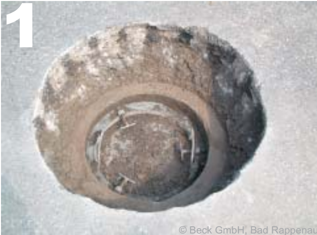
1 defekte Abdeckung ausbauen und Konus freilegen
