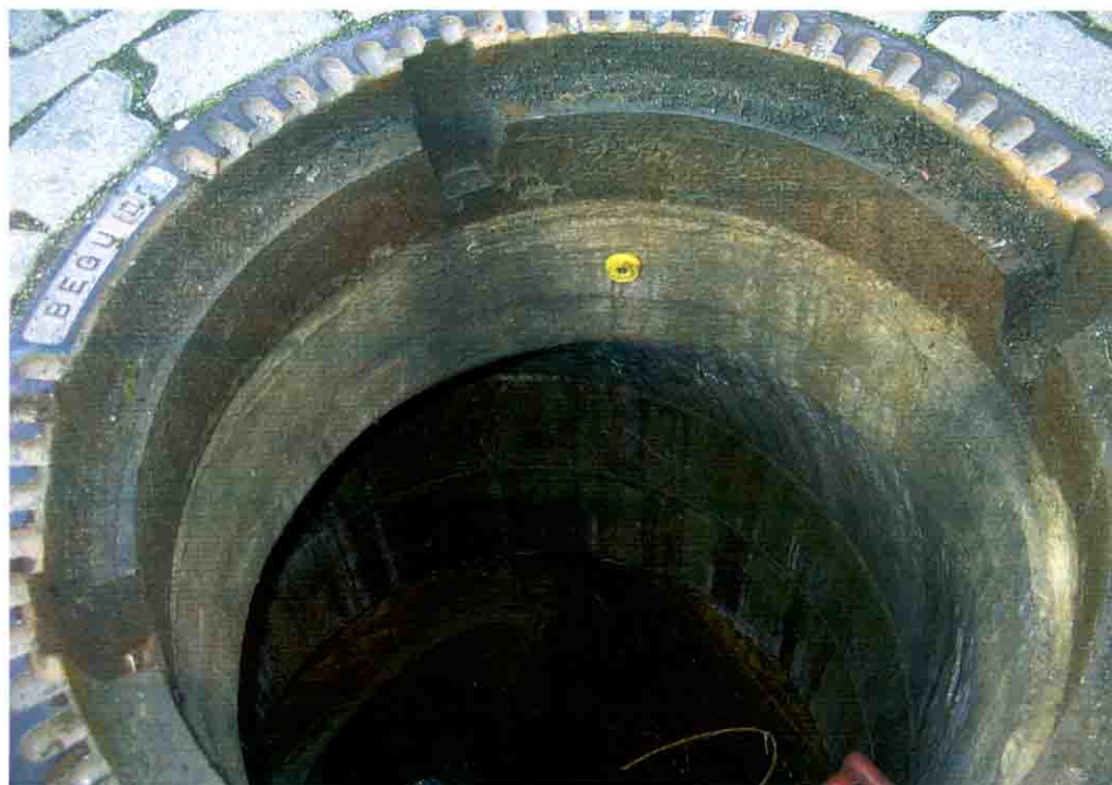
Schachtring mit Transponder
